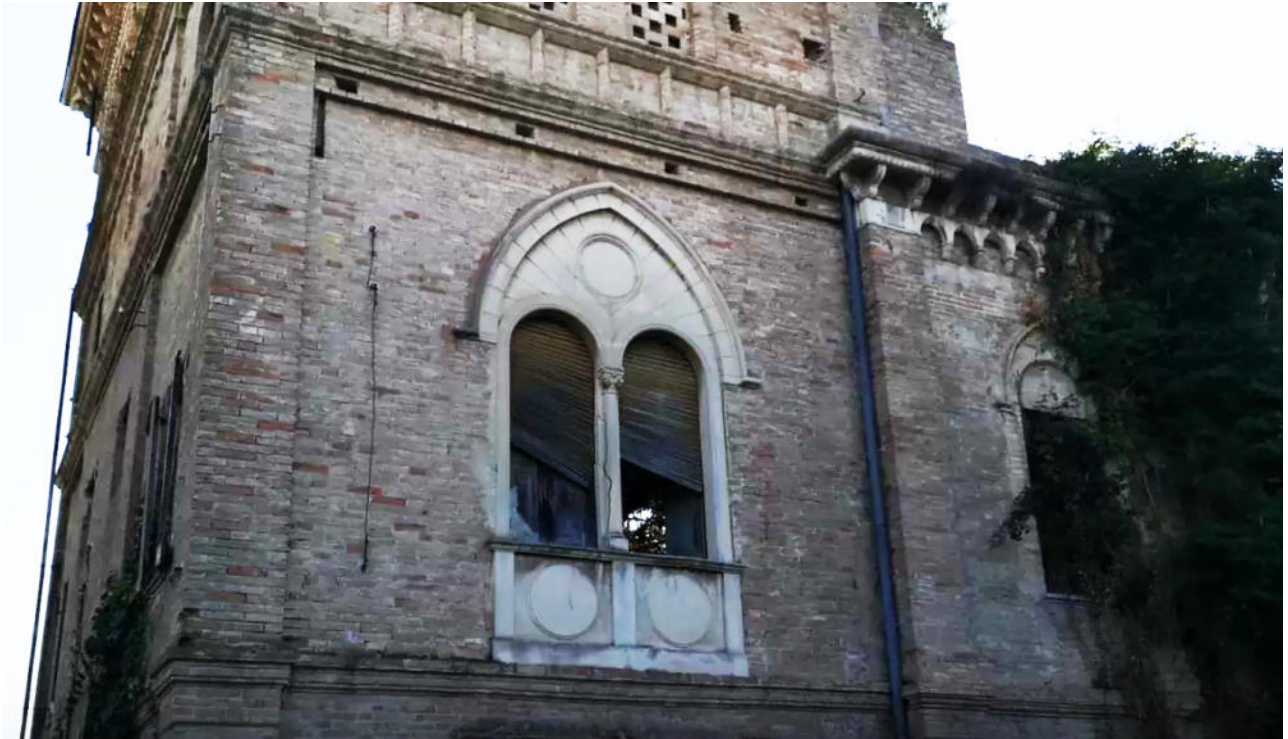
BIFORA DEL TORRINO - VISTA DI DETTAGLIO DALLA STATALE
